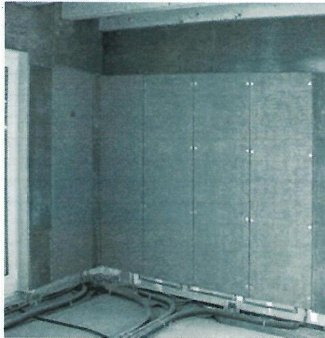
図22 配管を仕込んだ土パネルからなる壁暖房 (ボードは実になっていて、上塗りして仕上げる)
