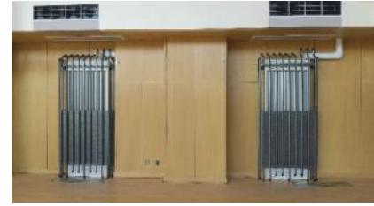
図7 中野区立令和小学校体育館の機器設置状況
