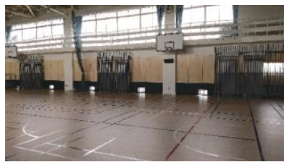
エアコン室内機とSCREENパネルが上下にセットで設置されている
