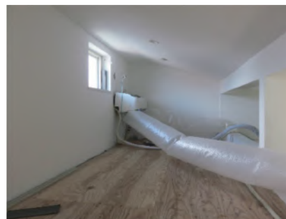
写真2 2階エアコン設置状況
