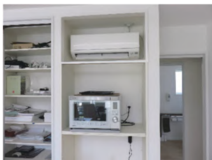
写真1 1階エアコン設置状況
